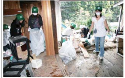
浸水家屋から廃物を出す学生ら＝24日、新宮市熊野川町玉置口
